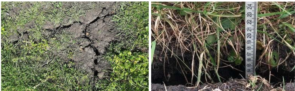
Krimpscheuren aan het oppervlak in het proefveld (links, mei 2022). Brede en diepe scheuren in het referentieveld (rechts, zomer 2022).
